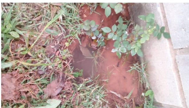
Vazamento de água na entrada da vila
