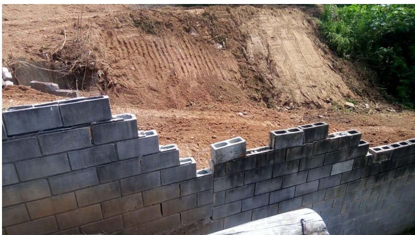
Muro danificado na limpeza do terreno ao lado
